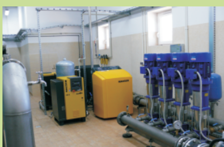
Nowe urządzenia w budynku SUW w Krasinie
