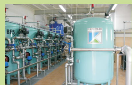
Hala filtrów w SUW w Krasinie
