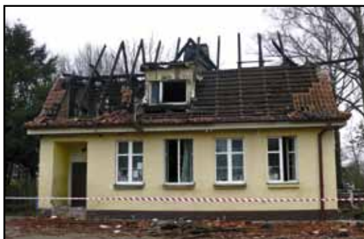
Budynek po pożarze 09/2017 r.
