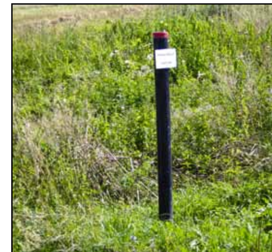
Budowa kanalizacji sanitarnej Rogajny – Gryżyna – Majki, Zielonka Pasłęcka – etap I Pasłek – Gryżyna.
