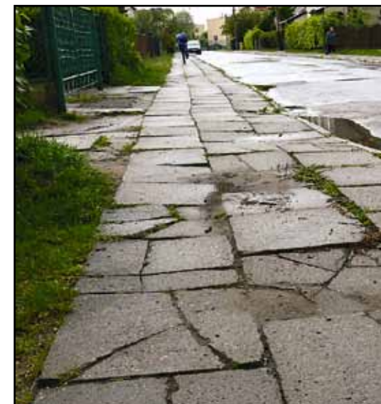
Chodnik przy powiatowej ulicy Limanowskiego w Pasłęku przed wykonaniem remontu.
