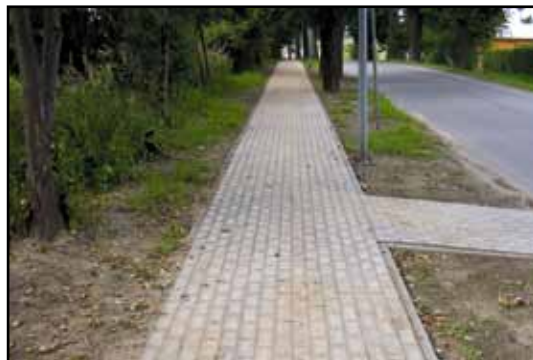
Wyremontowany chodnik przy powiatowej ulicy Dworcowej - etap I - odcinek od przejazdu kolejowego do skrzyżowania z drogą dojazdową do przedsiębiorstwa SERY ICC PASŁĘK.
