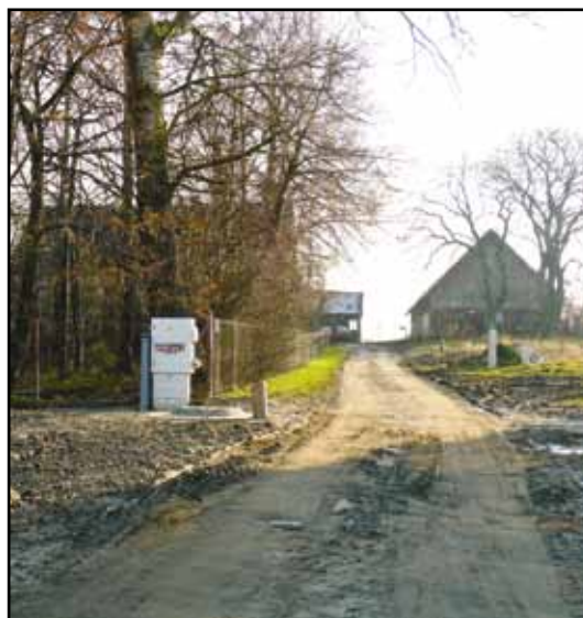
Przepompownia ścieków – ul. Kolonia Zdroje.
