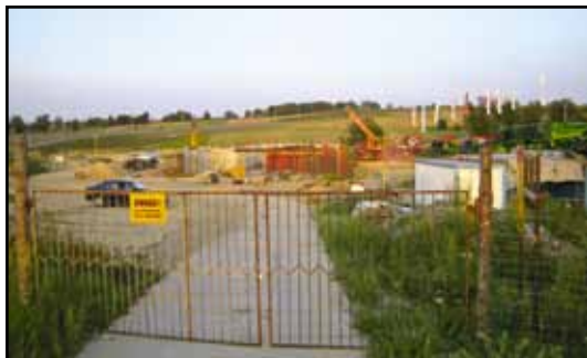
Budowa centrum obsługi podróżnych przy węźle Pasłęk Południe drogi S7 w obr. Nowa Wieś.
