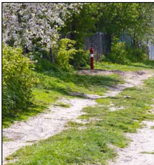
Hydrant na zakończeniu sieci.
