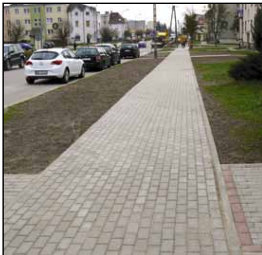
Wyremontowany chodnik przy ul. Ogrodowej na odcinku od skrzyżowania z ul. Kopernika do skrzyżowania z ul. Zwycięstwa.
